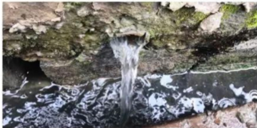
图8 绿色江南工作人员发现管道正在排水
